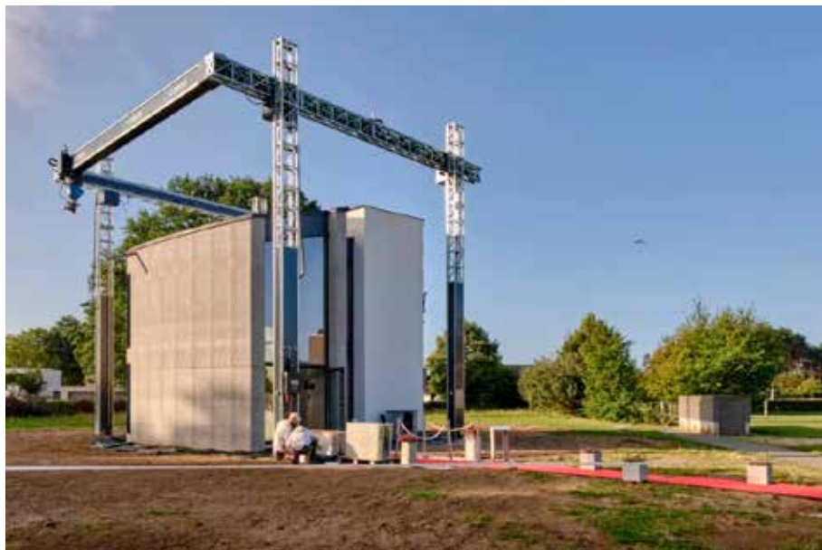
Slika 3. 3D štampa (Izvor: https://www.gradnja.rs/wp-content.jpg )
